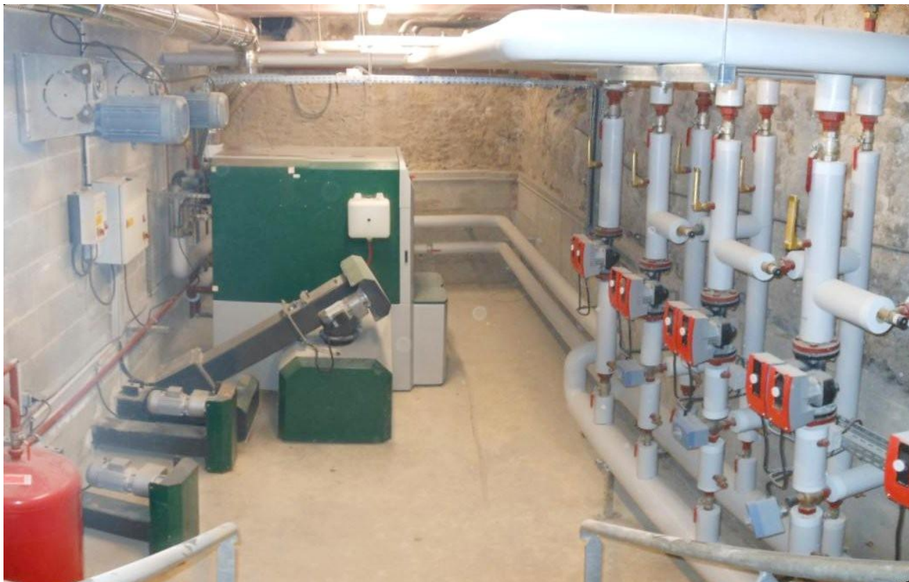
Réseau bois : la chaudière chauffe désormais les 4 bâtiments communaux.
