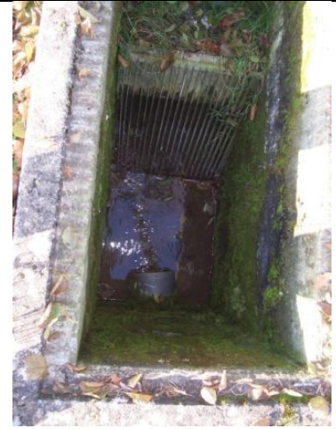
et dégrilleur de la station de Cheyssac.
